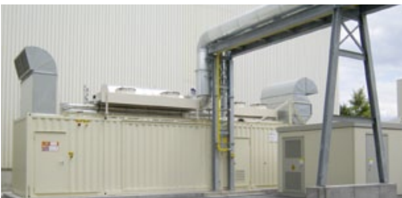
Dezentrale Blockheizkraftwerke helfen, Energieverluste zu vermeiden.
